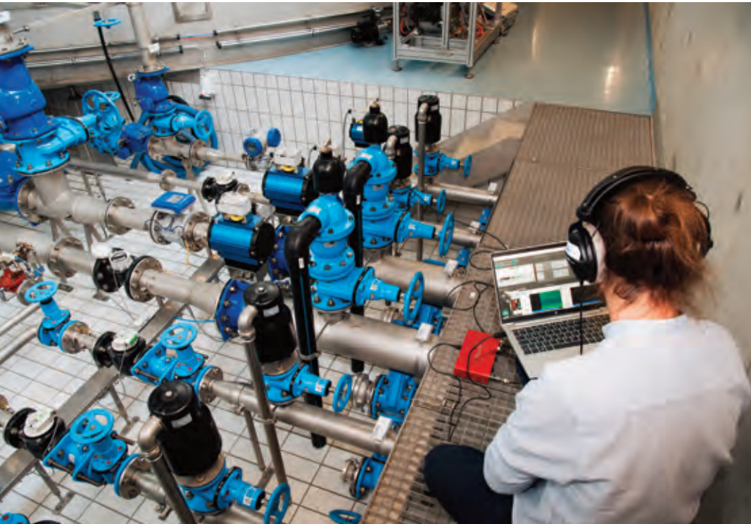
Ventilfeld beim ZHB Weinleiten, welches mittels Körper- und Luftschallmikrofonen sowie Infrarotkamera überwacht wird.
